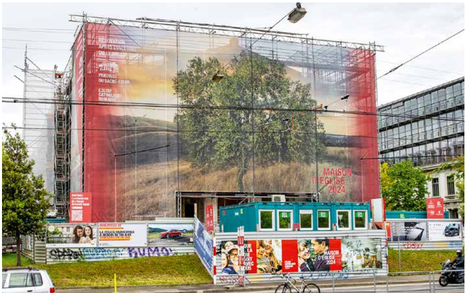
La reconstruction de l'église du Sacré-Cœur est en cours au centre de Genève.
